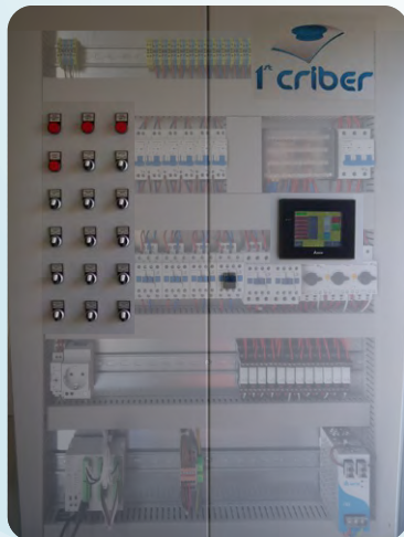
Panou de control stație de epurare METROPOLIS
