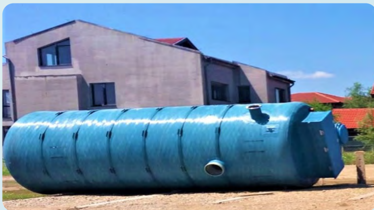
Stație de pompare ape uzate pluviale, 3 pompe active (9m lungime)
