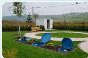
Stații de epurare
